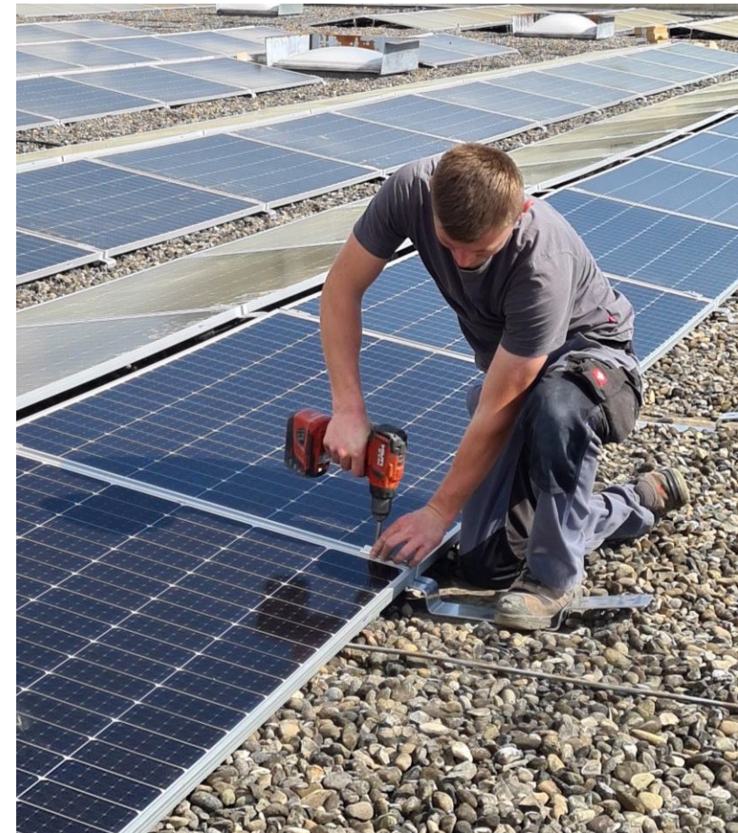
Photovoltaikanlage auf den Dächern unserer Hallen.
